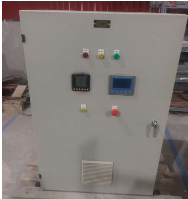
Hình 2.12. Mặt trước của tủ điện
