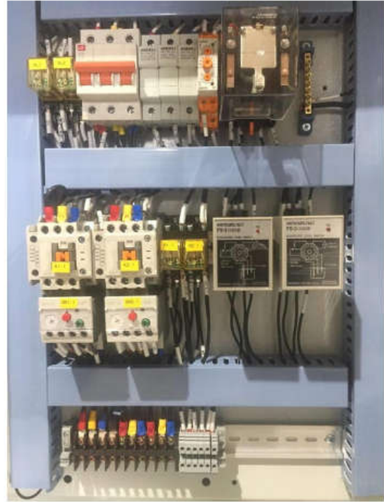
b) Tủ bơm nước lên mái
