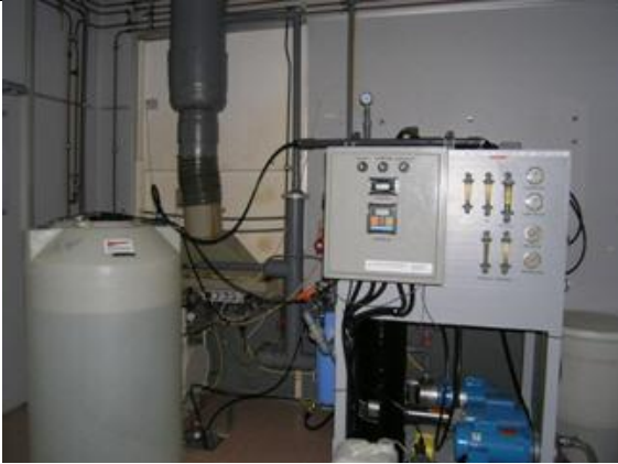
DI water System
